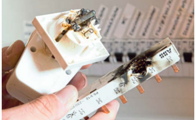
Verschmort: Steckdose und eine Schiene aus dem Sicherungskasten. Alte Elektrotechnik kann brandgefährlich sein. FOTO: RALF BITTNER
